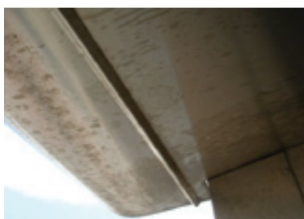
Afbeelding 4: gevelement van roestvast staal dat niet gereinigd kon worden door regelmatige regenbuien.
