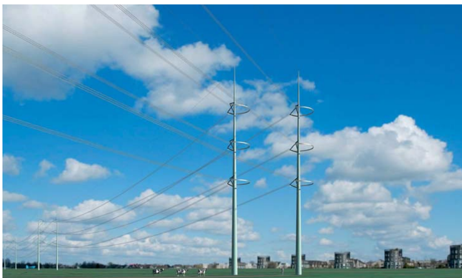
Bij het Wintrack-concept hangen de hoogspanningsdraden dichter bij elkaar en ook onder elkaar (foto: Tennet)
